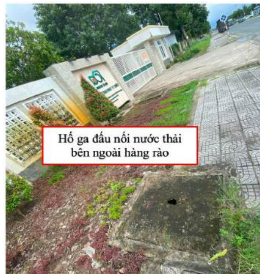
Hình 3.7. Hồ ga thu gom nước thải, đầu nối nước thải
